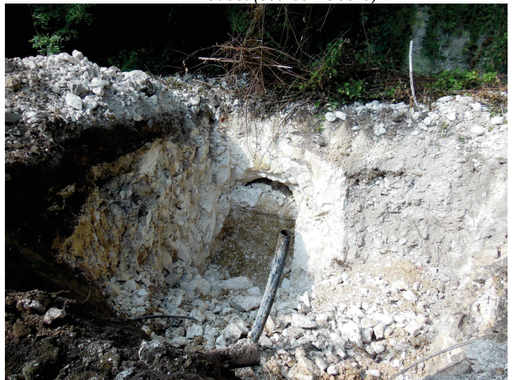
photo 11: Vides inférieurs au terrain naturel connu depuis 1849 et recoupés par des travaux de construction (source : Géolia)
