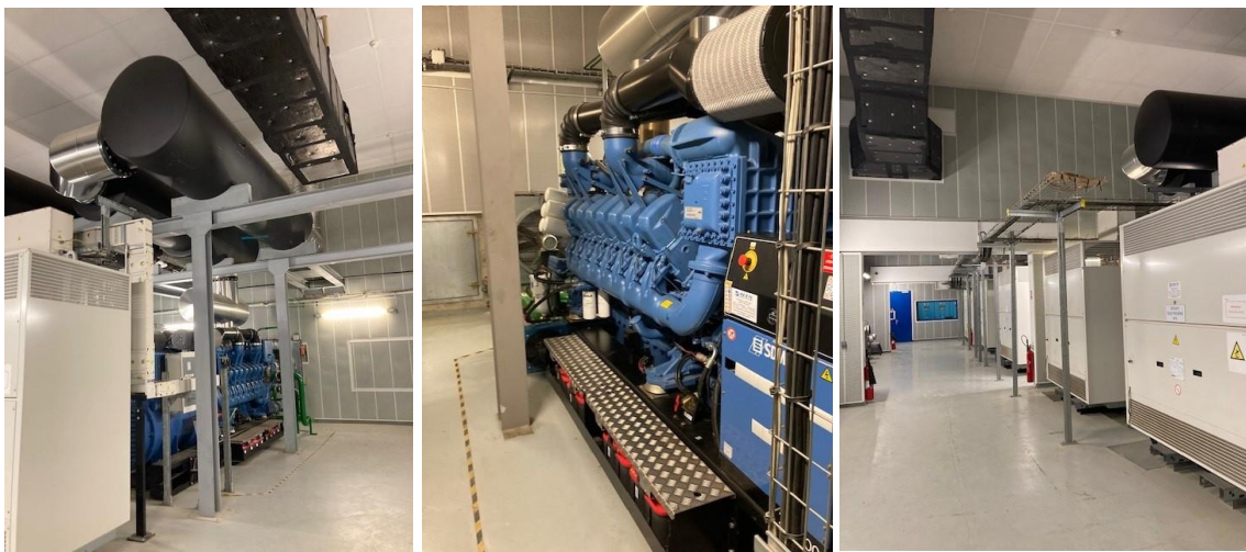
Figure 5 : Groupes électrogènes présents dans le bâtiment U
